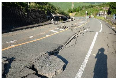
道路のひび割れ
